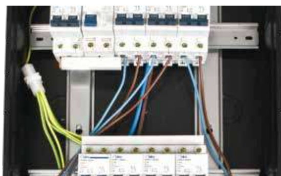
Large space for wiring Grand espace pour le câblage
